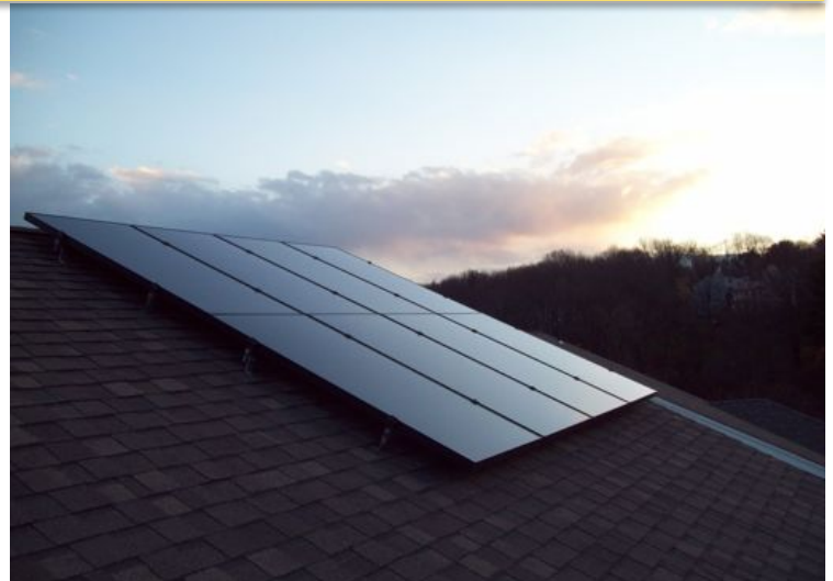
1.68kW Solar Array
